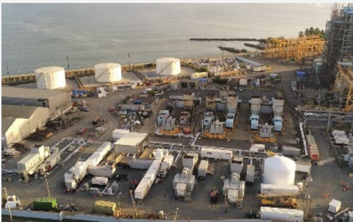
Palo Seco Fast Power 175 MW
